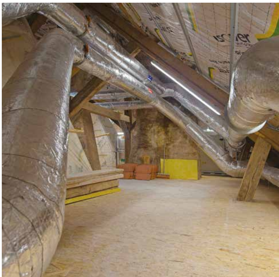
Vaste réseau de ventilation implanté dans les combles.
