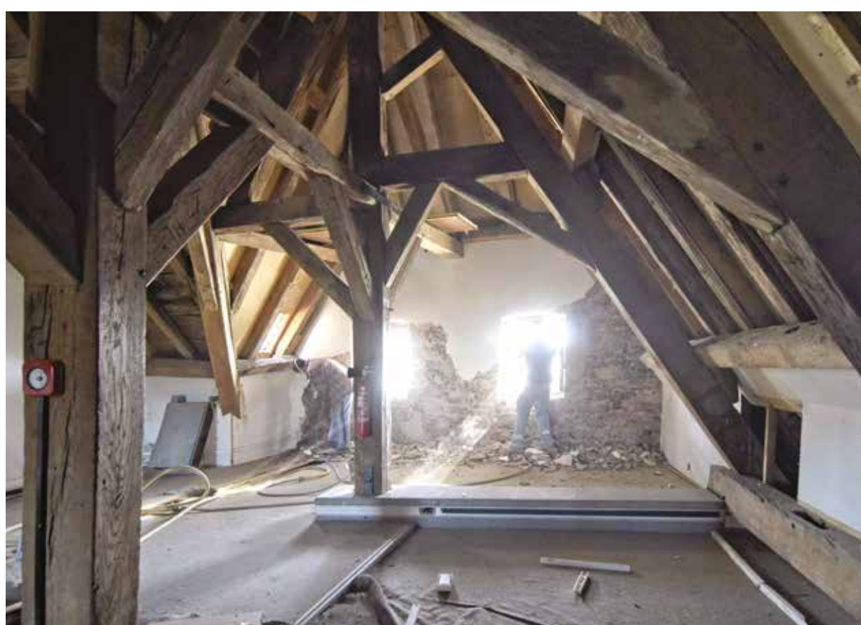
Des travaux datant des années 70 ont été source de désordres.
