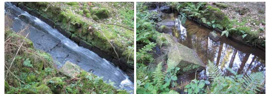
Abb. 3: Der bauliche Zustand von Triftanlagen an Bächen ist sehr unterschiedlich.
